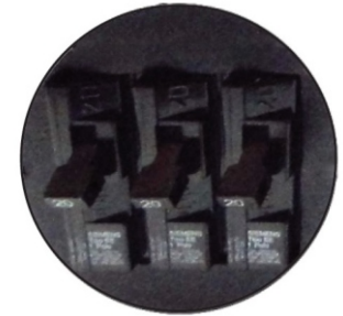
Interruptores termo magnéticos o llave térmica
